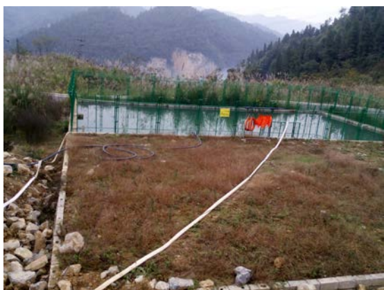
焦页 21#西废水池
