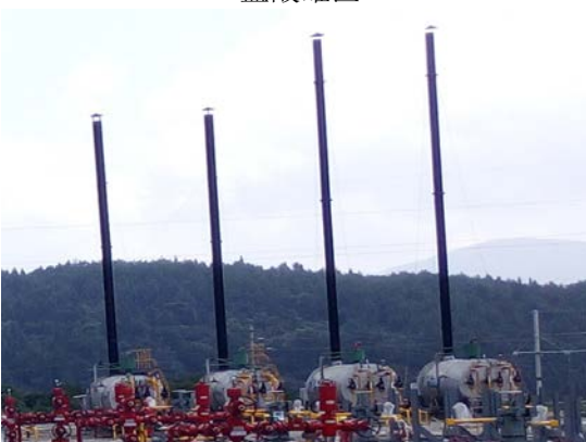
水套炉排气筒
