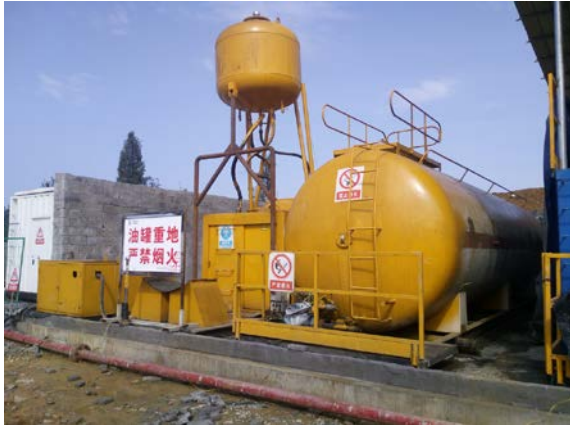
焦页 11#西柴油罐围堰+防渗
