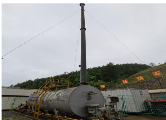
水套加热炉及排气筒
