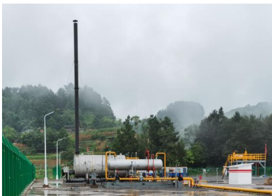
水套加热炉及排气筒
