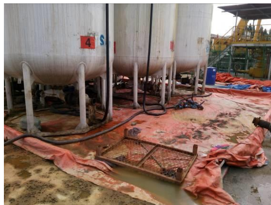
盐酸罐底部围堰+防渗膜
