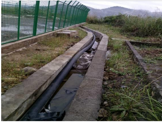
井场周边截排水沟
