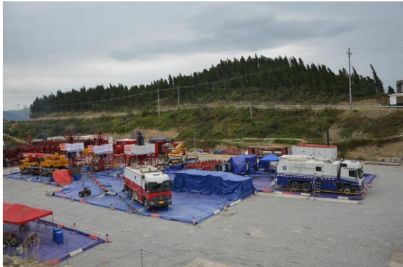
压裂机组设有围堰及防渗膜
