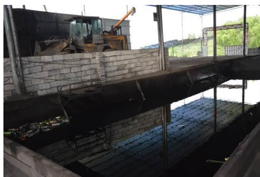
油基钻屑暂存池
