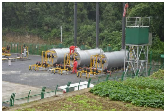
集气站水套炉排气筒
