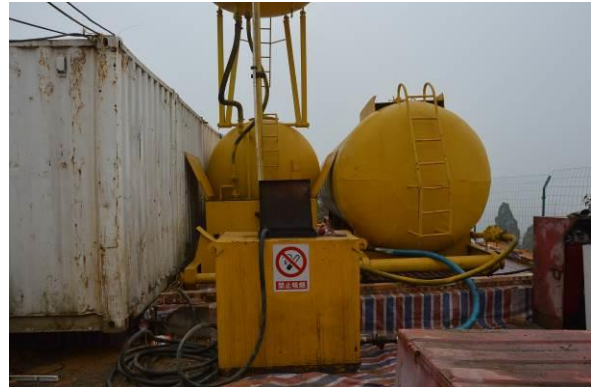
柴油罐区设有围堰
