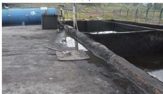
1#油基钻屑回收站清、废水池
