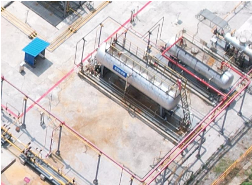
废水预处理装置（密闭除硫罐）
