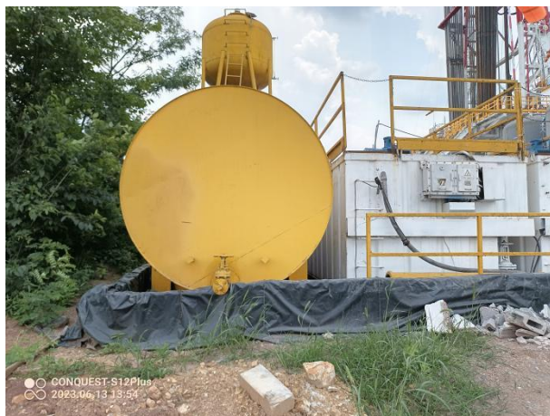
柴油罐区及围堰
