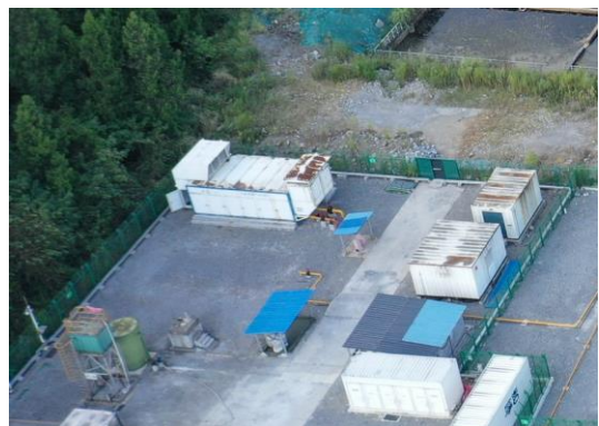
压缩机（置于撬装内）
