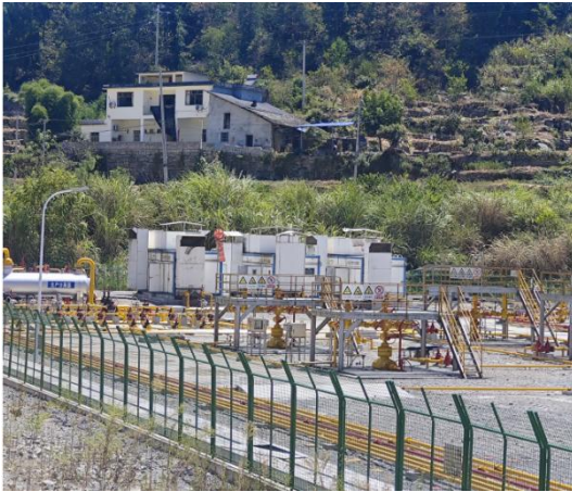
压缩机撬（焦页 19 号平台）
