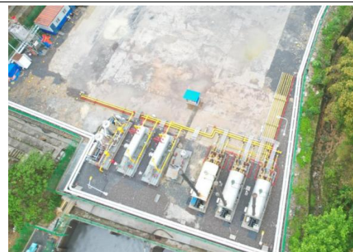
水套加热炉及排气筒（停炉）
