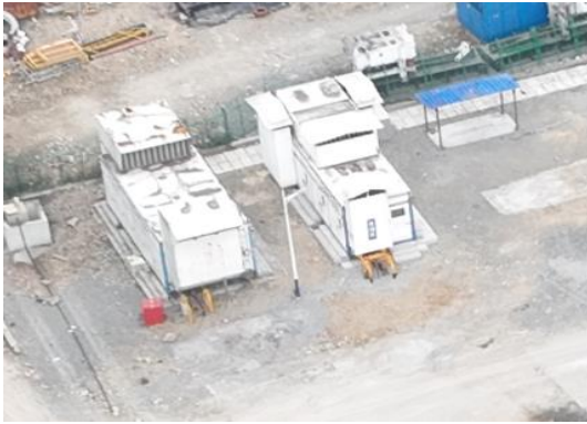
压缩机撬（焦页 6 号西）
