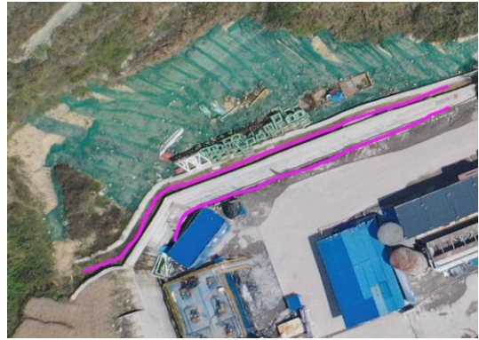
截排水沟（焦页 81 号西）
