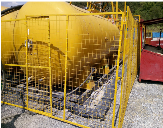
焦页 107#柴油罐防渗+围堰
