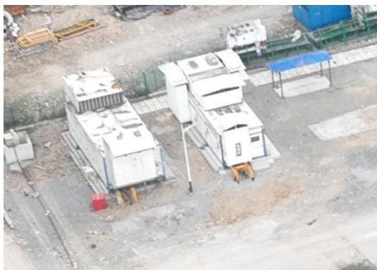
压缩机撬（焦页 10 号平台）
